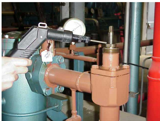
Photo 1 : Déplacement de la sonde « au plus près » des zones potentiellement fuyardes
